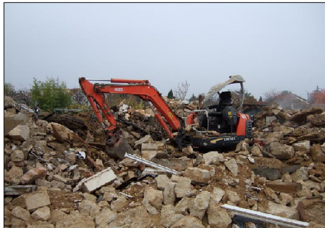
Niort (79) le 04/11/2007 Explosion d'un pavillon
